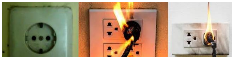
Gambar 11. Korsleting pada lubang stop kontak
